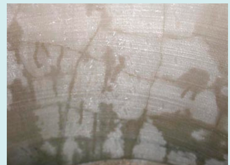
Risse sind oft erst nach ein paar Monaten gut zu erkennen
