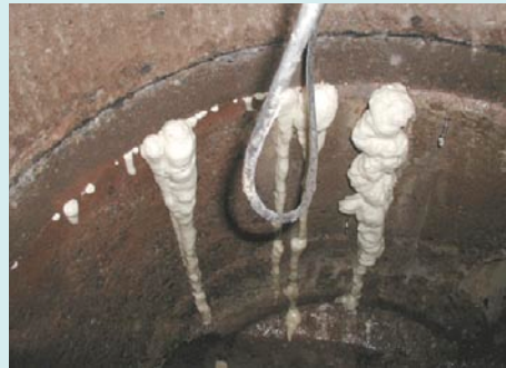
Durch undichte Stellen in einer Ringfuge eines Betonschachtes eintretendes Injektionsmaterial
