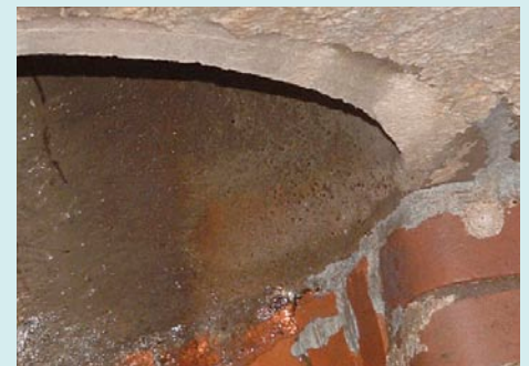
Undichtigkeiten im Gerinne im Bereich der Einbindung des Ablaufs
