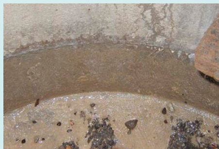
Undichte Ringfuge in einem Schacht aus Betonfertigteilen
