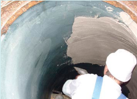
Grün-schwarze Verfärbung der Vorbeschichtung in einem Schacht mit starker Schwefelsäurebelastung
