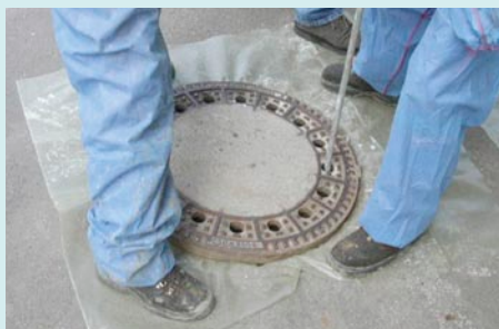
Ein Abdichten des Schachtdeckels allein reicht nicht aus
