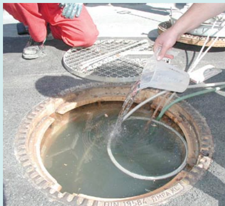
Eine Dichtheitsprüfung des Schachtes ist häufig nicht geeignet, um die Qualität einer Beschichtungsmaßnahme beurteilen zu können
